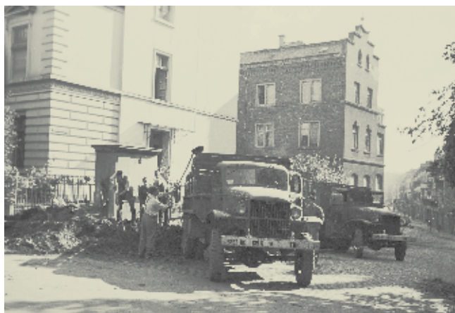
Aufräumarbeiten im Sommer 1945 Ecke Hellmundstraße und Emser Straße. Quelle: Stadtarchiv Wiesbaden.
